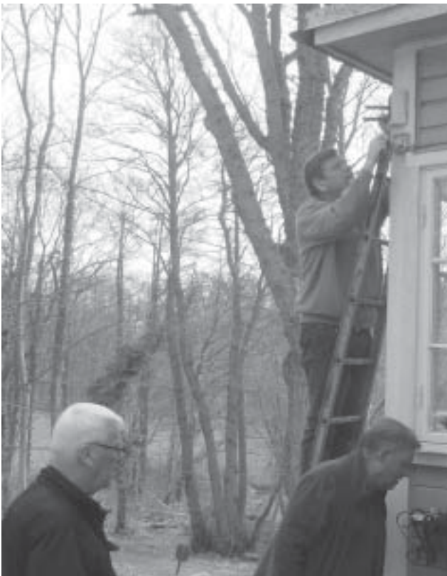
Gunnar Medemyr stod för monteringen av ytterbelysningen under övervakning av Jan-Olof Pettersson.
